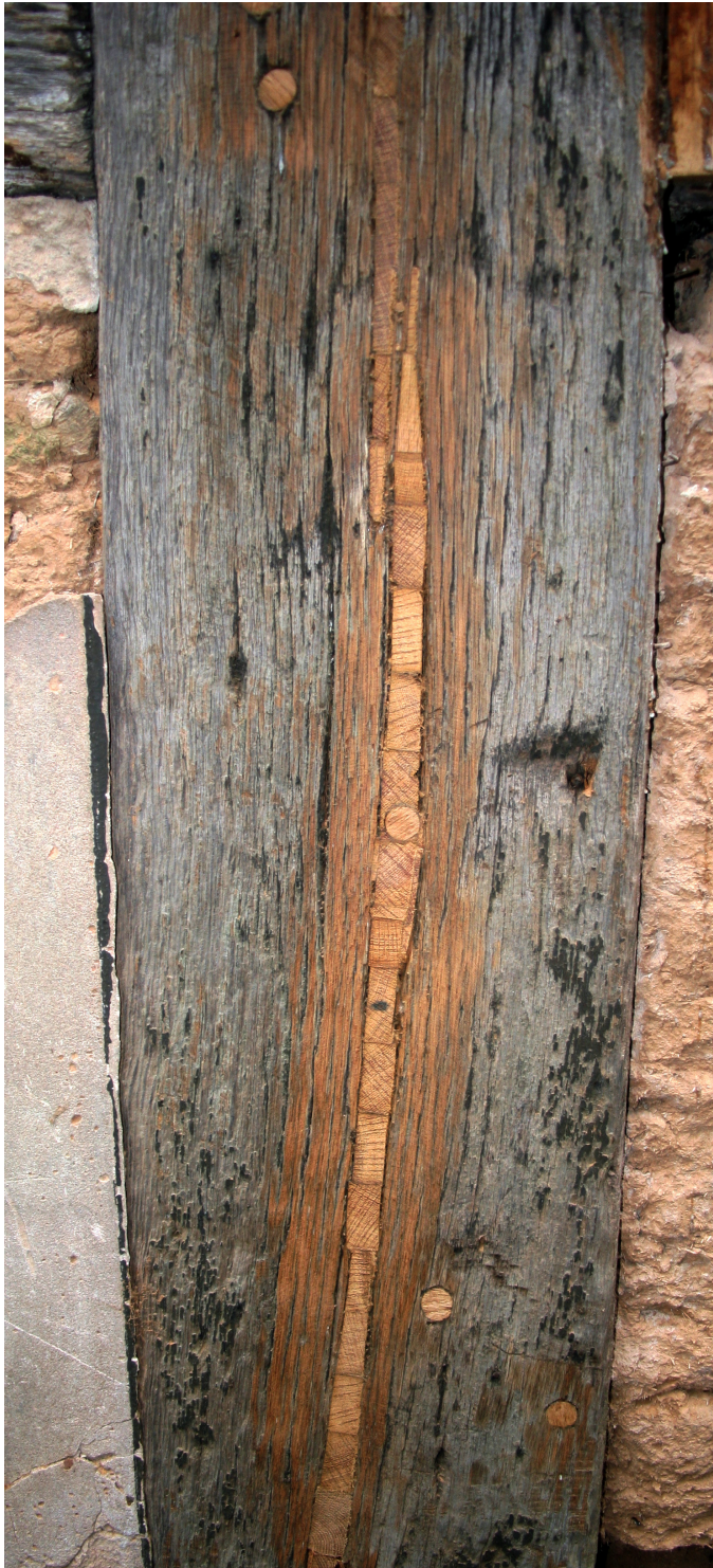
Maroder Holzbalken im Burgsitz Quelle: www.wir-heben-schätze.de
